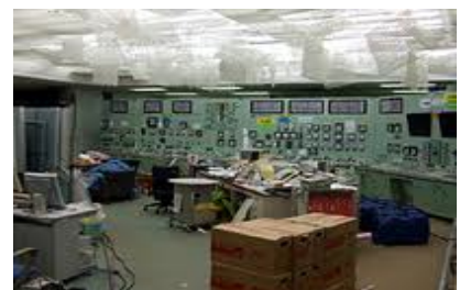
地震の影響で天井が破損した福島第一原発1号機中央制御室＝24日午後1時撮影（東京電力提供）
