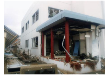
東京電力福島第1原発敷地内にある警備員が休憩したりする保健安全センターの入り口付近。壁が壊れ、鉄骨があらわになった＝23日（撮影、提供は経産省原子力安全・保安院）
